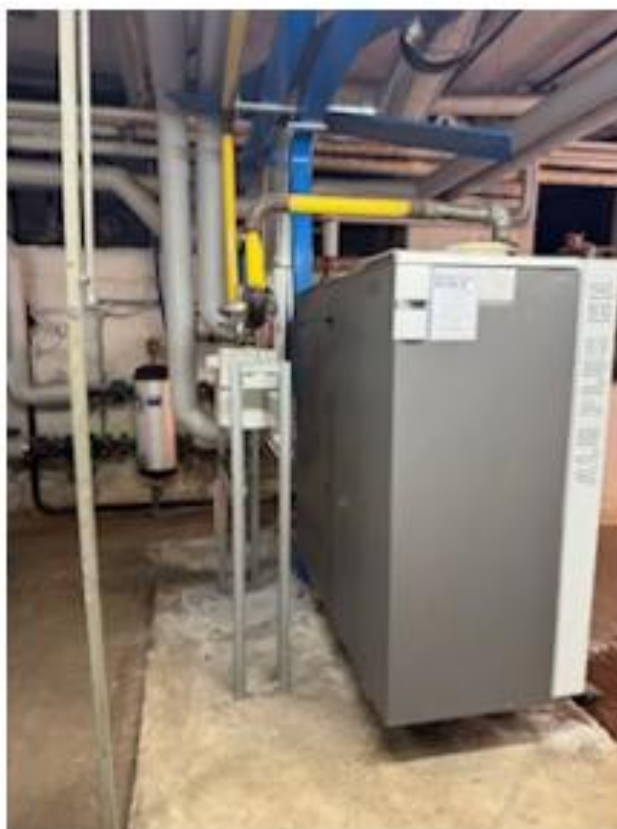
Centrale termica interrati Sub 730
