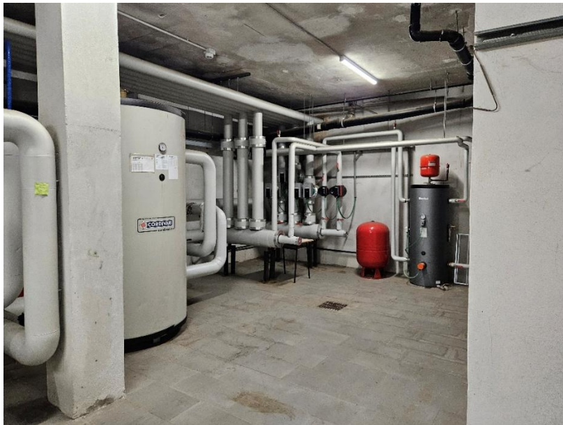
Piano Interrato -Locali tecnici seminterrato
