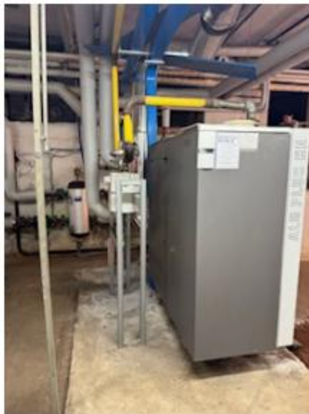
Centrale termica interrati Sub 730
