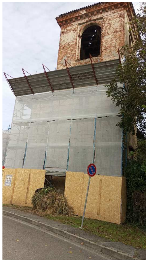
Viste Facciata in via Costituzione - messa in sicurezza e ponteggio (foto recente)
