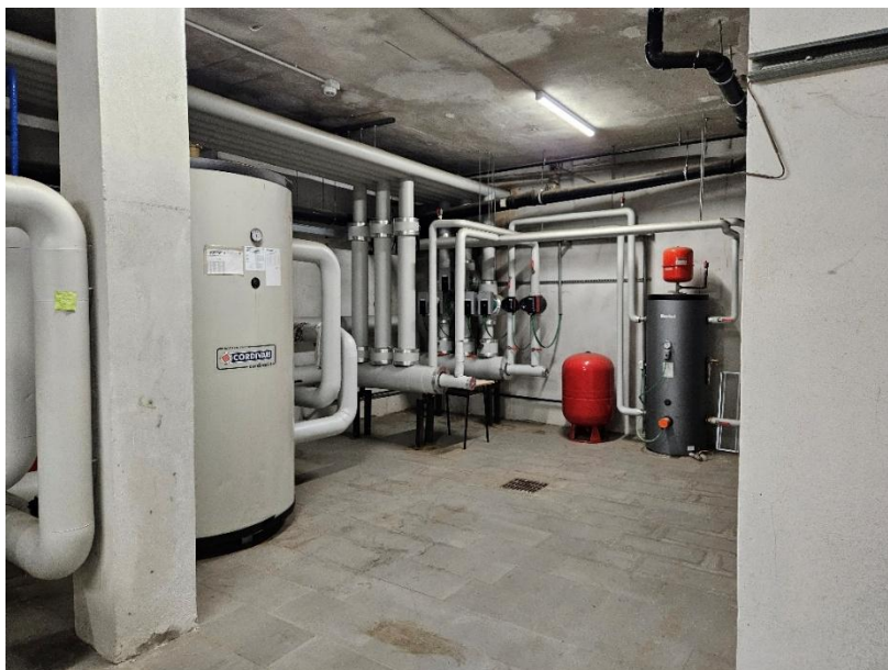
Piano Interrato -Locali tecnici seminterrato
