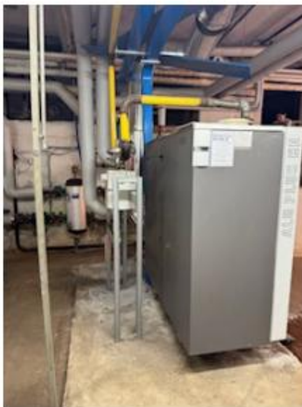
Centrale termica interrati Sub 730
